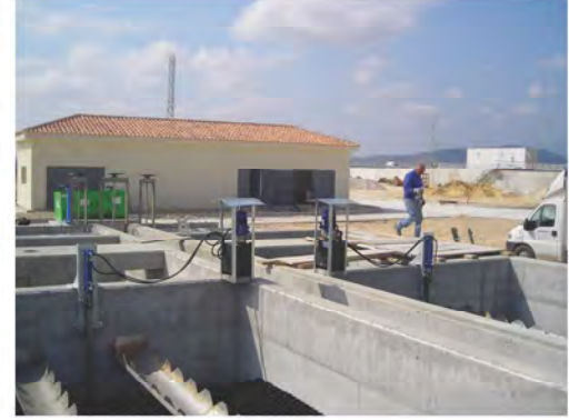
TRAITEMENT DE L'EAU POTABLE
