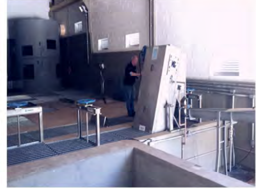
PLANTES DE TRAITEMENT DES EAUX USÉES
